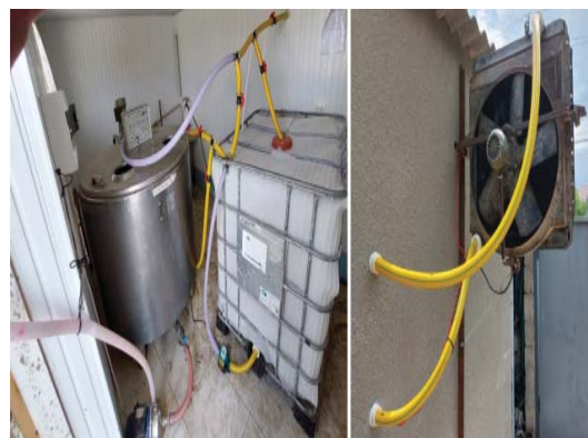
Fig. 3. Instalația frigorifică (Foto)
